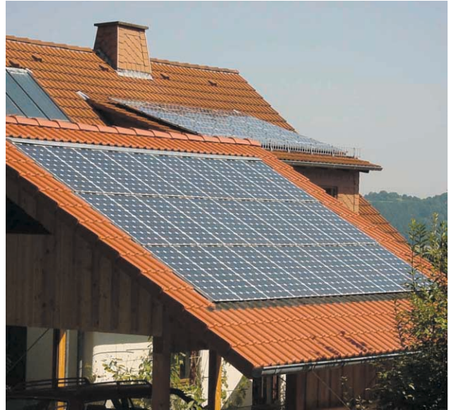
Bild 8 Laminatmodule in das Dach eines Carports integriert
