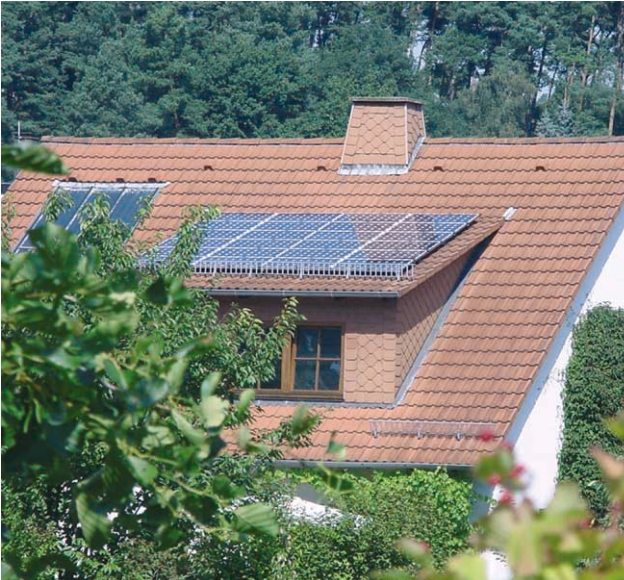
Bild 11 2kW-Photovoltaikanlage auf einer Dachgaube installiert
